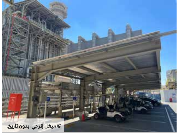
الشكل ٤٨: محطة شحن للمركبات الكهربائية تعمل بالطاقة الشمسية في مصنع ألبا.
